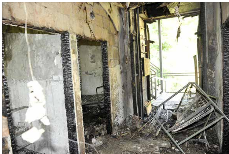
Slika 13: Opožarena unutrašnjost – Pogled prema požarnom stubištu na sjeveroistočnoj strani objekta
